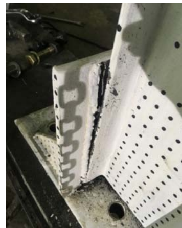
شکل (۲۳): آسیب ایجاد شده در جوش.
