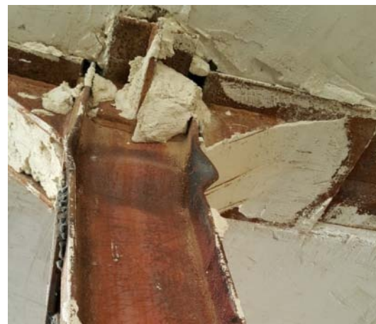
شکل (۶): تشکیل مفصل پلاستیک در ستون.
