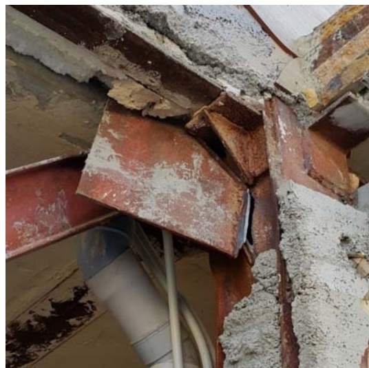
شکل (۱۲): آسیب در اتصال.
