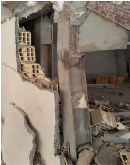
شکل (۱۳): آسیب در ستون.
