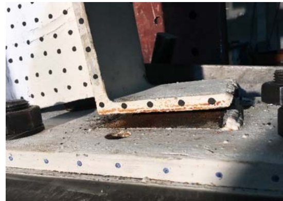
شکل (۲۷): نمایی از آسیب ایجاد شده در اتصال.
